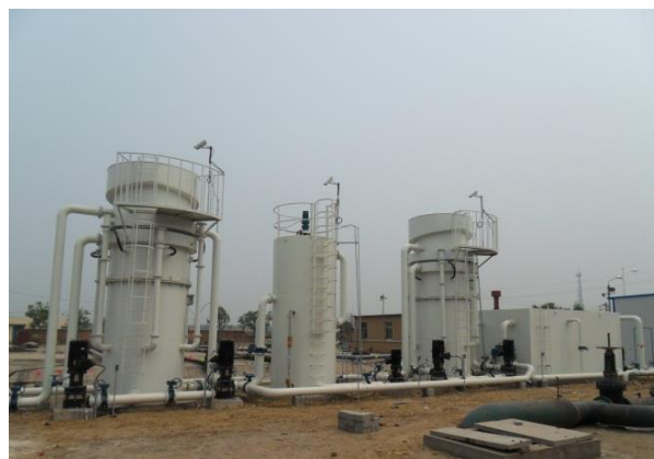
胜利油田采油污水浮选柱 分离工艺示范工程
